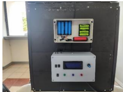
Fig.10 Ubicación del sistema de control y las baterías para el sistema
