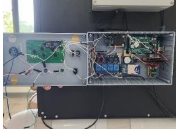
Fig. 9 Elementos instalados en la caja de control
